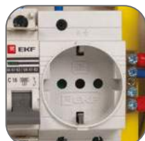
Имеется узел подключения строительного инструмента
