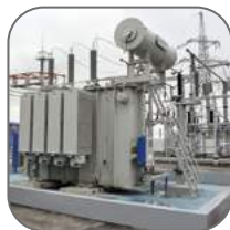
Объекты энергетической отрасли
