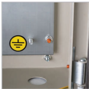
Шпилька заземления на монтажной панели.
