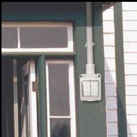
Двухклавишный выключатель, установленный в герметичную коробку IP 55 для открытой проводки
